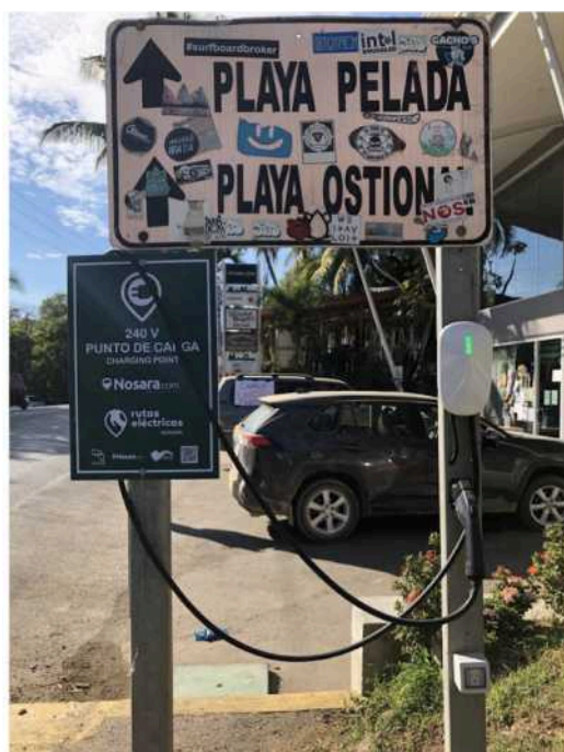
Figura 17. Punto de carga para vehículos eléctricos en Nosara. Incluye estación semi-rápida y tomacorriente 120V para motocicletas, bicicletas y carritos de golf eléctricos.
